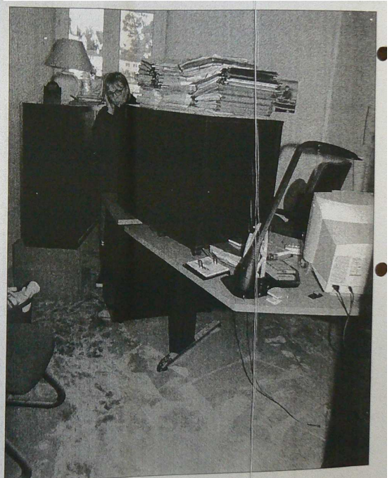
Danièle Fogam, directrice de la communauté de communes, dans les locaux inondés. Même les téléphones posés sur les bureaux surélevés ont pris l'eau.
