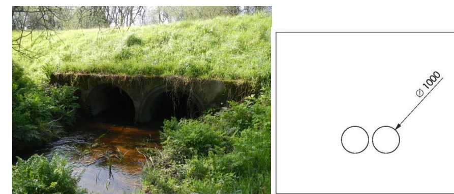
Les ouvrages sur la RN 164 actuelle : 2 Ø1000 mm (OH B)
